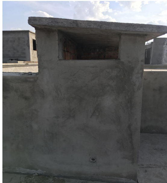
发电机专用排气通道（楼顶）
